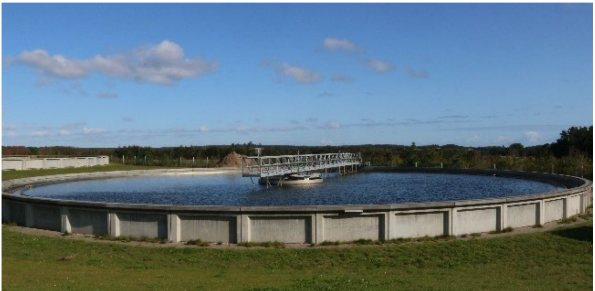
Billedet viser en klaringstank © Mariagerfjord Vand A/S
