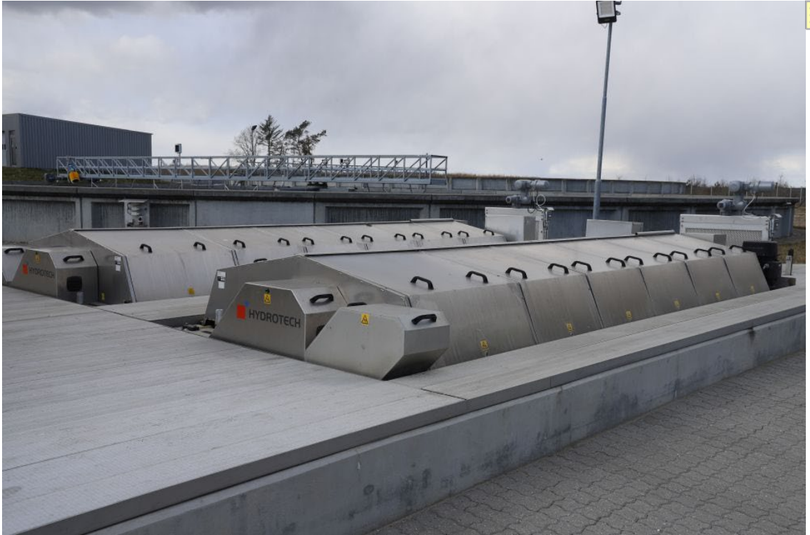
Billedet viser det tertiær filteranlæg på Mariagerfjord Renseanlæg © Mariagerfjord Vand A/S.
